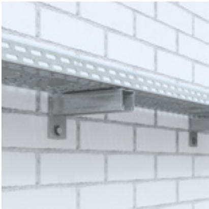
Chemins de câbles
